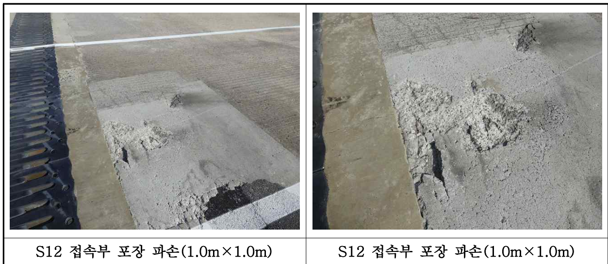
【사진 5.3.20】 교면포장 손상현황
